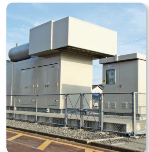
非常用発電設備
