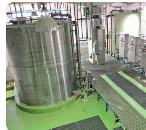
薬品注入設備
