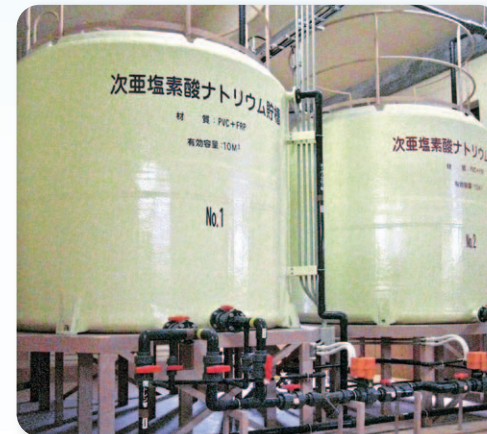
次亜塩素貯槽
