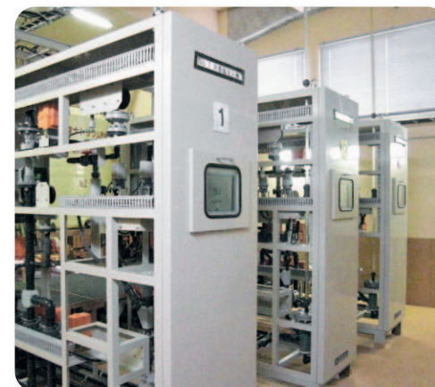
次亜塩注入設備
